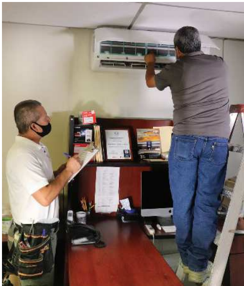
Compra, instalación y mantenimiento de aire acondicionado en las oficinas.
